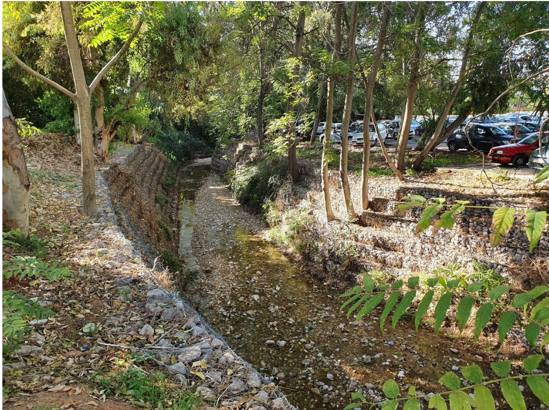
Εικόνα 43. Παράδειγμα αρμονικής ένταξης συρματοκιβωτίων στο φυσικό οικοσύστημα του ρέματος (περίπτωση ρ. Χαλανδρίου)
