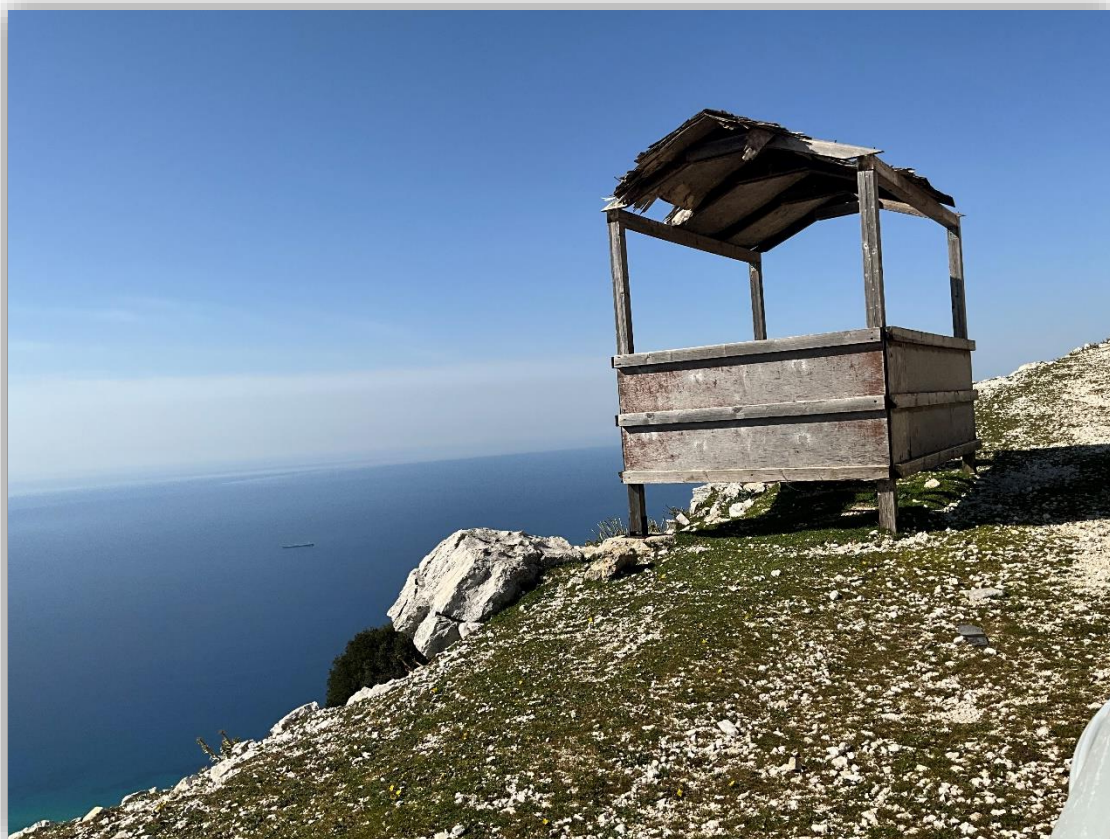
Εικόνα 64: Ξύλινο πυροφυλάκιο Ελειού Πρόνων, παλαιού τύπου με εμφανείς φθορές.
