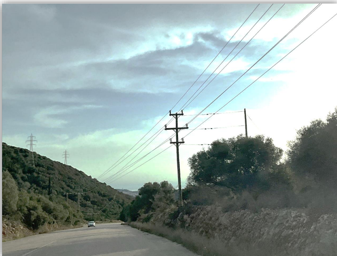
Εικόνα 83 : Διερχόμενες γραμμές υψηλής και μέσης τάσης σε εκτάσεις με πυκνή δασική βλάστηση βόρεια του Αργοστολίου.
