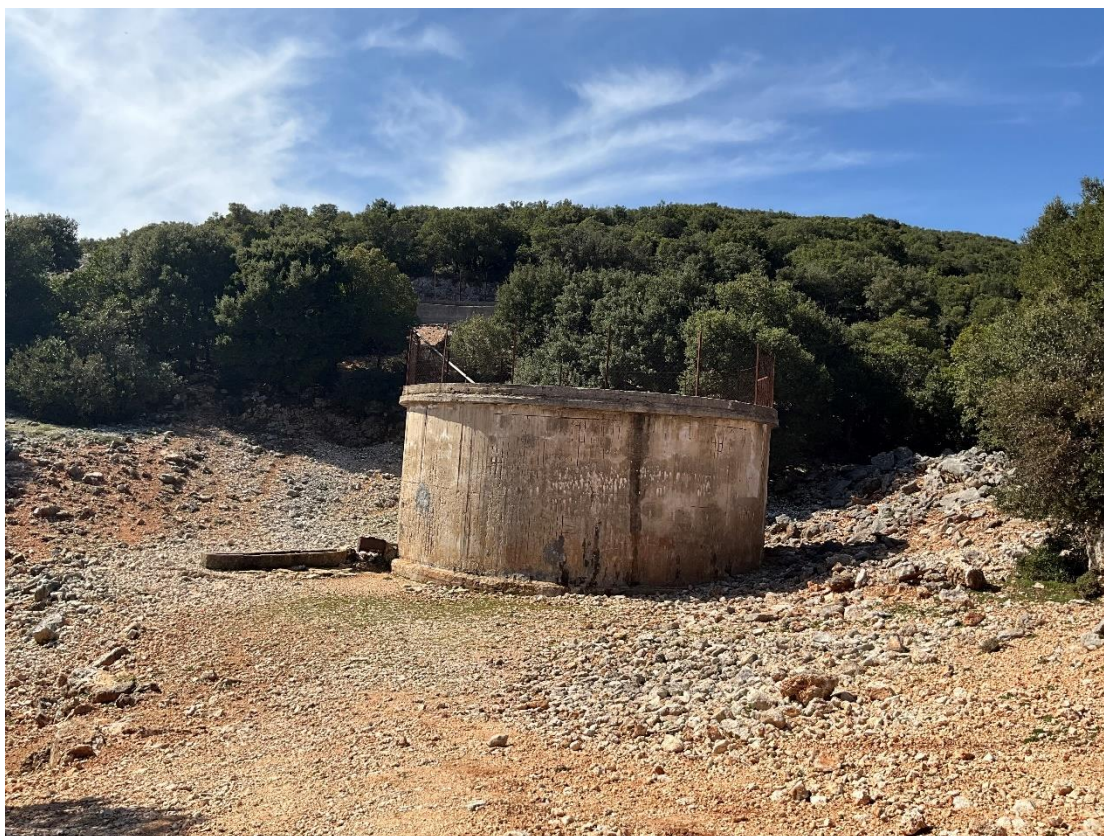
Εικόνα 77: Εγκατεστημένη τσιμεντένια υδατοδεξαμενή χωρητικότητας 250 κυβικών μέτρων, βόρεια του οικισμού Βαλσαμάτα.
