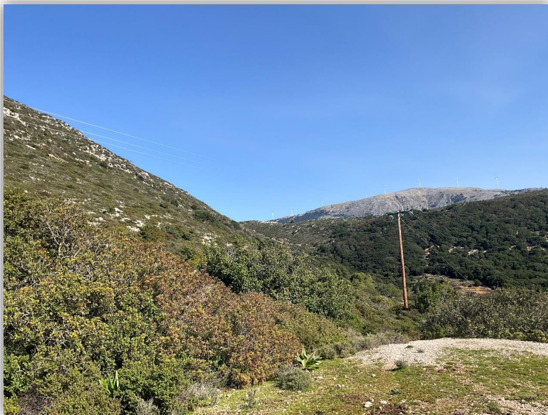
Εικόνα 57: Πυλώνας μέσης τάσης που διασχίζει περιοχές θαμνώδους και φρυγανικής βλάστησης
